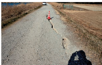
2. 震災直後、土手道のひび割れ(3月)
